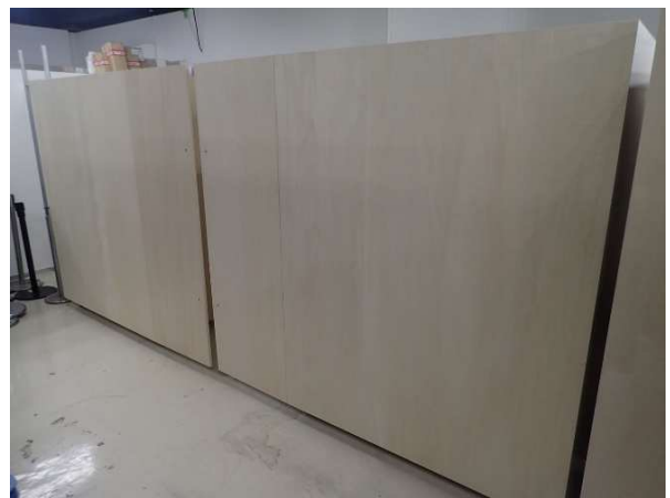
No1-No2 箱配置状況(扉開け)
