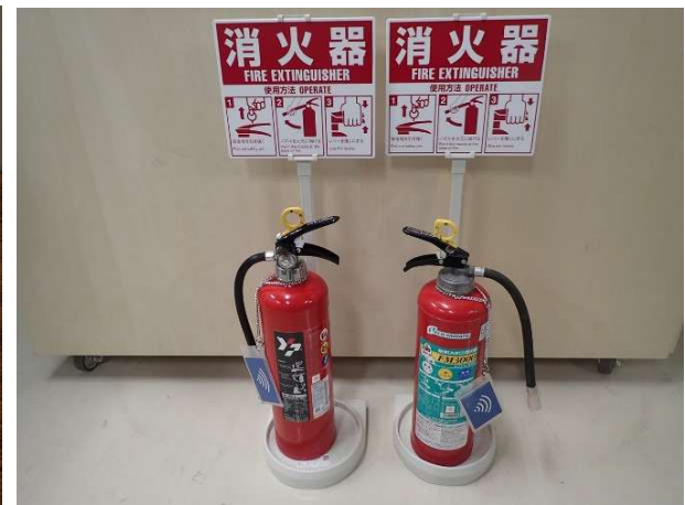
消火器(2種類、使用期限切れ、使用期限内)
