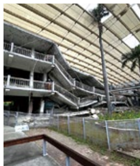
1999年9月21日の921大地震で倒壊した中学校の校舎を当時のまま保存
