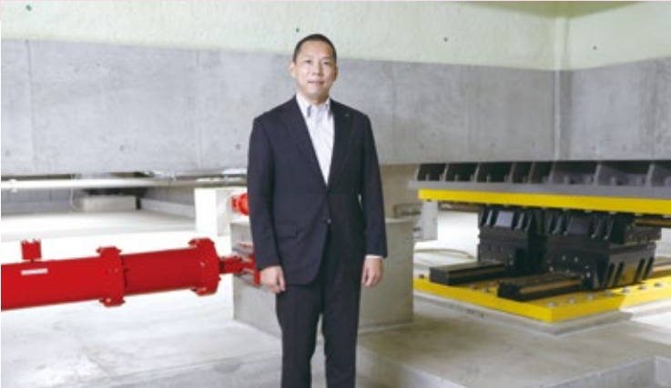
THK 本社ビルを支える地階の免震装置と共に。建物と地盤が切り離され、その間に免震装置(右)が配置され1基当たり1,000tを支える。左は揺れを吸収する制震用ダンパー
