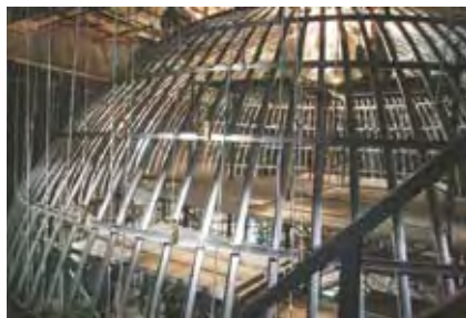
【ドームスクリーンの構造】 従来の工法の倍以上の密度でフレームを配置することで、ドームの強度と球面精度を向上
