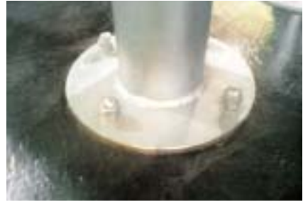
【アンカーボルト部の安全対策】 ゆるみ防止のためダブルナット締めにするとともに、袋ナットを取りつけて、当たりをやわらげるようにしている
