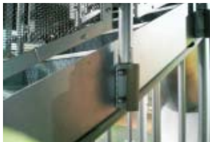
【階段及び手摺り部の安全対策】
