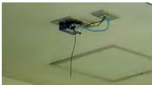
図 3 . 2 - 1 6 [RFID リーダ] 天井に設置された RFID リーダ
